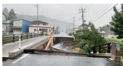
令和3年8月10日 早朝 小赤川橋（大畑）崩落現場
